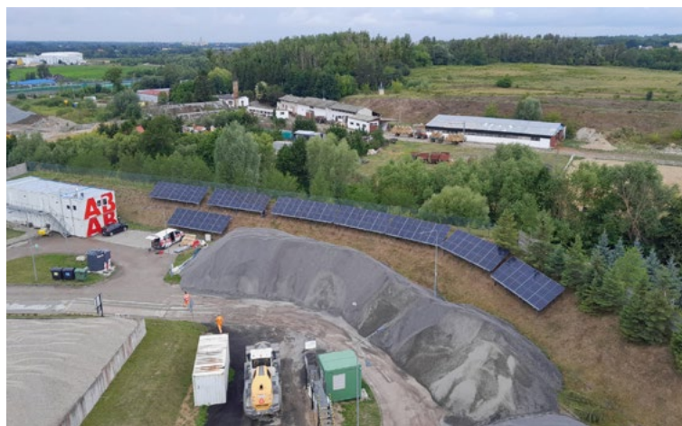
Fot. Instalacja PV gruntowa o mocy 48,6 kWp – WMA Elbląg
