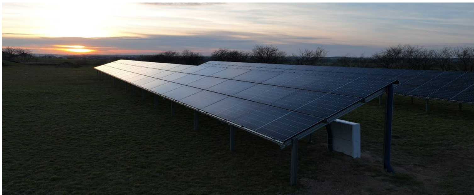
Fot. (lewe) Instalacja PV gruntowa o mocy 48,6 kWp – Region Południe STRABAG BMTI Komorniki
