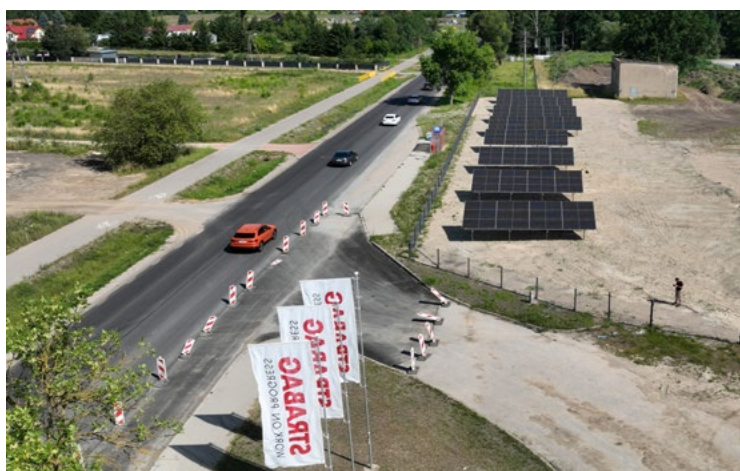
Fot. Instalacja PV gruntowa o mocy 48,6 kWp – Oddział STRABAG w Hryniewiczach..
